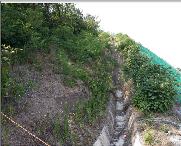
③ Sta.7+300부근(영천) 산마루 측구 배수로 청소상태 불량
