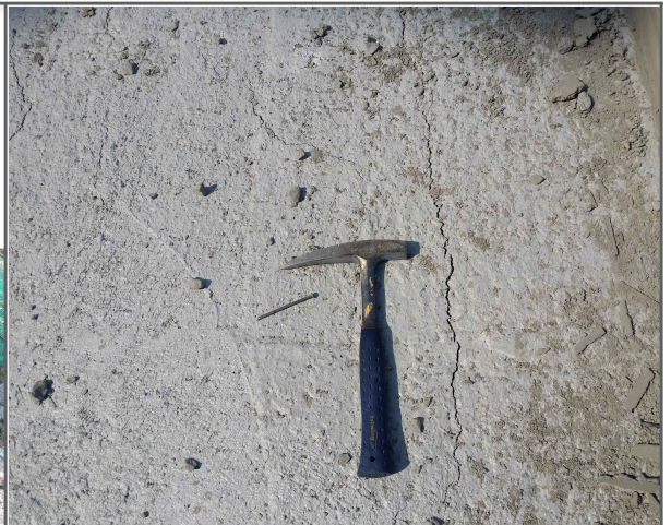
④ Sta.7+300부근(영천) 20m 소단 횡방향 균열 발생
